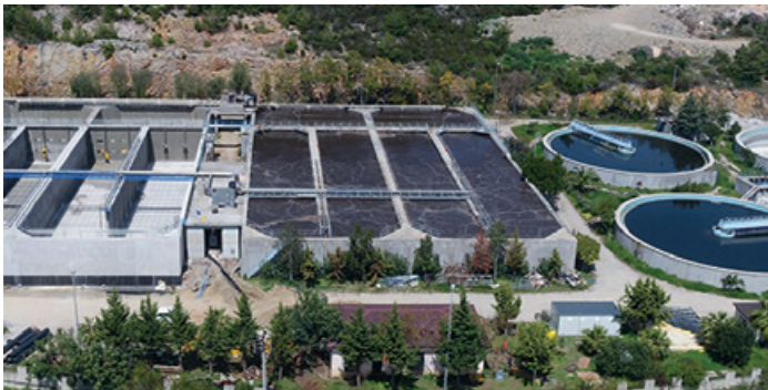
Alanya Konaklı Belediyesi Arıtma Tesisi
