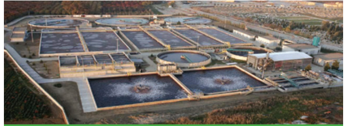
Bursa Gürsu Arıtma Tesisi
