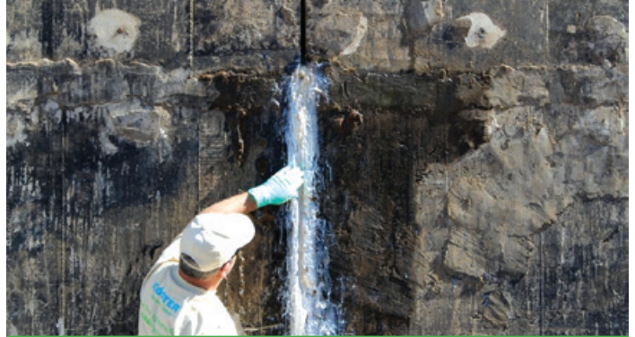
Trabzon Akçaabat Belediyesi İçme Suyu Deposu
